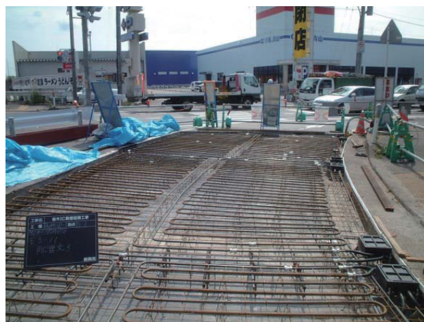
③放熱管設置状況
