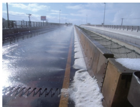
③壁高欄埋設の消雪パイプ
