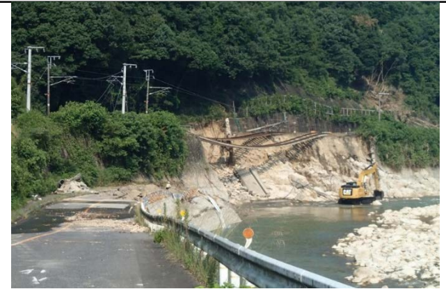
鉄道の被害 (広島県東広島市 JR山陽線)
