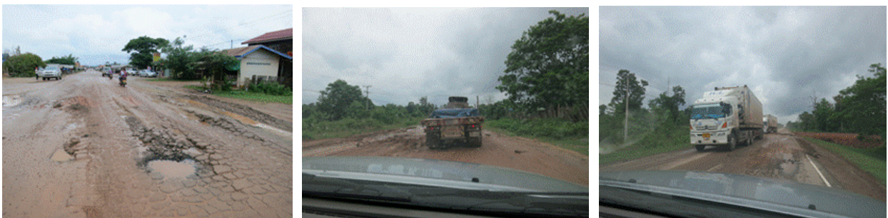
図 2-36 改良プロジェクトに含まれない区間における損傷箇所（同様の損傷箇所が何箇所も見られる）
