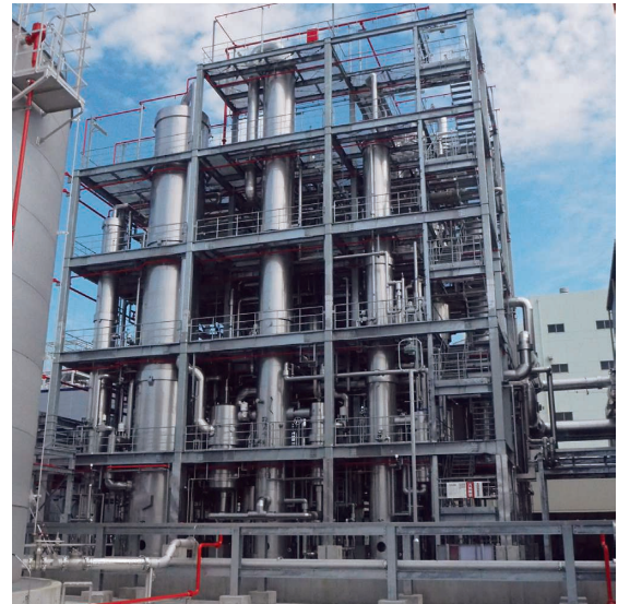
合同酒精清水工場 アルコール蒸留設備
