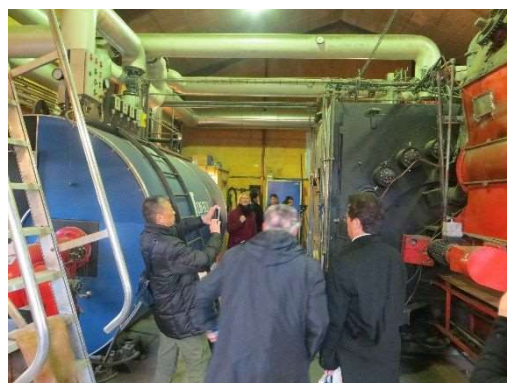
ボイラー室の様子
