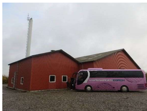
地域暖房施設（わらボイラー）
