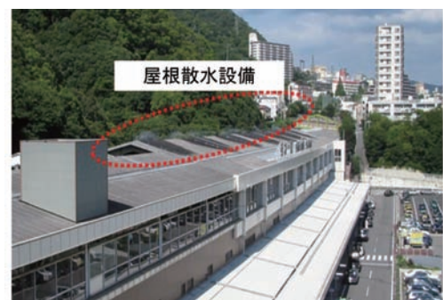
写真 5 新神戸駅屋根散水設備
