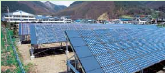
葛巻中学校の太陽光発電施設
