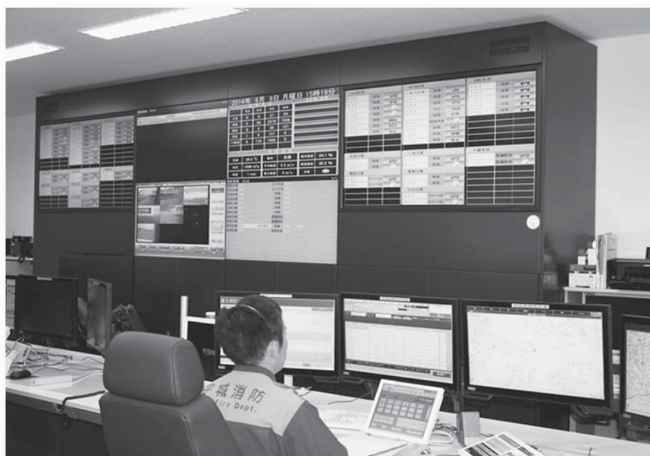
高機能消防指令センター 消防救急デジタル無線システム (平成26年4月運用開始)
