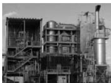
サーマル実証プラント (愛知県半田市)
