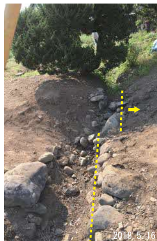
右横ずれした水路
