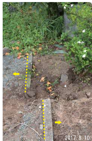
左横ずれした水路
