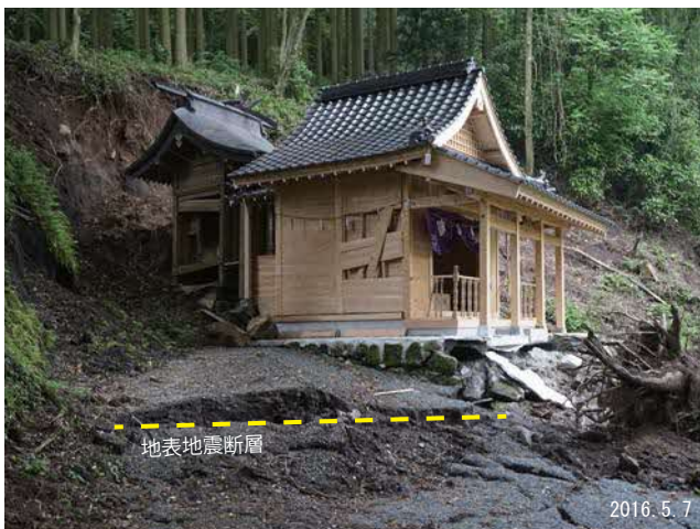
地表地震断層と本殿、拝殿
