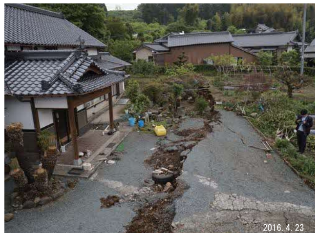
民地内に表れた地表地震断層
