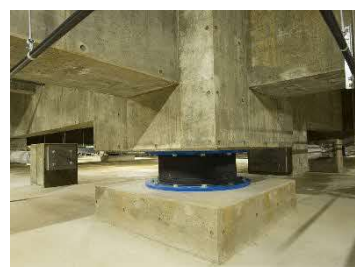
▲免振装置の例【南城市】
