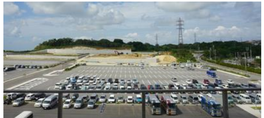
駐車場整備の様子。約2,000台駐車可能。災害時の避難場所としての使用も見据え、電気・上下水道の管路も敷設している。
