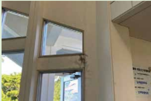
▲1階壁面雨漏り箇所
