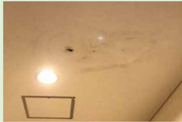
▲1階廊下雨漏り箇所
