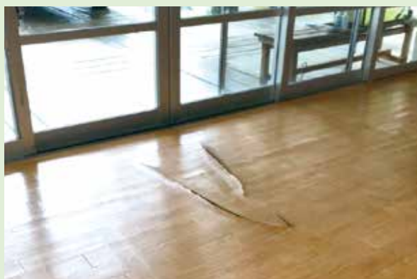
▲地下フロアカバー破損箇所
