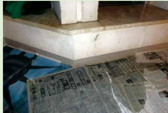
▲1階壁面雨漏り箇所
