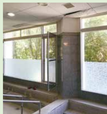
▲多額の設備修繕を繰り返してきたお風呂 (天井破損)
