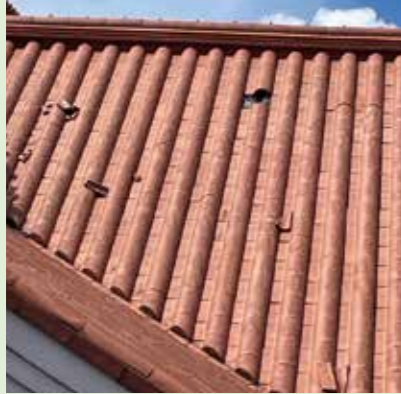
▲屋根瓦の破損
