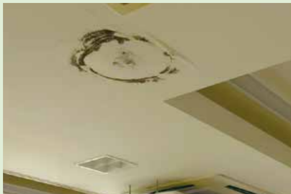
▲2階会議室雨漏り箇所
