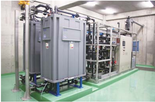
イオン交換膜・電気透析ユニット
