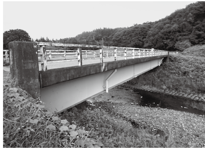
早期の補修が望まれる橋
