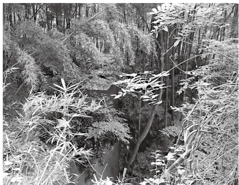
繁茂した竹に行政も対策を（治山ダム）
