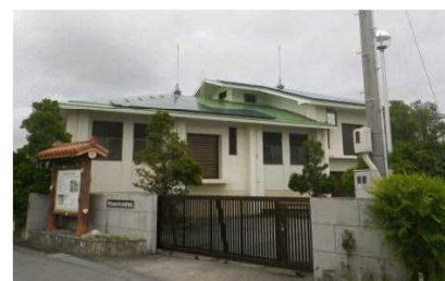
▲神里地区農業集落排水処理施設
