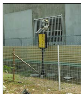
↑ 設置した監視カメラ
