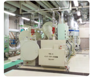
錦糸町熱供給施設
