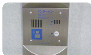
非常用インターホン
