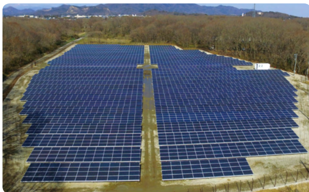
東武岩舟太陽光発電所
