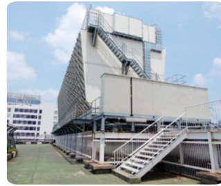
西池袋熱供給施設
