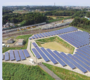
東武高柳太陽光発電所 (東武エネルギーマネジメント)
