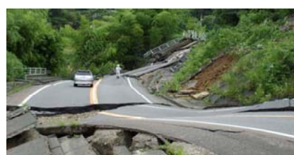
被災状況調査
