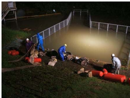
浜町排水ピット
