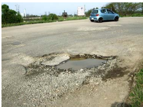
堤防の天端舗装補修前の状況
