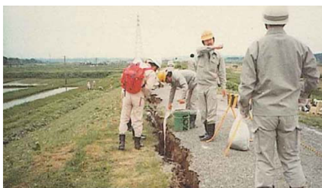
日本海中部地震で発生した堤防の亀裂に石灰水を注入することにより亀裂深を調査（秋田市牛島地区）
