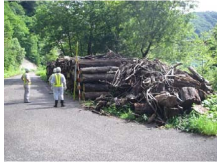
流木処理の状況
