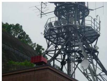
玉川ダム 放流警報施設
