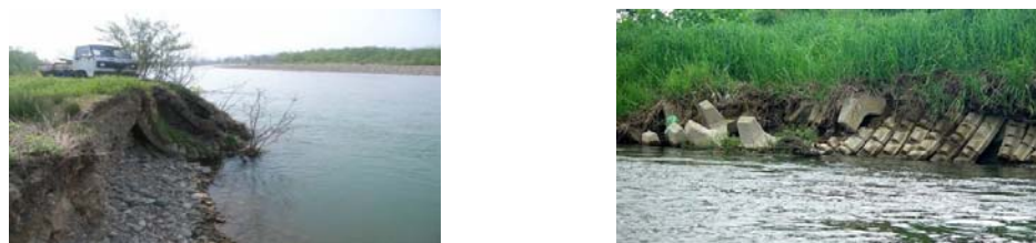
河岸崩壊の状況
