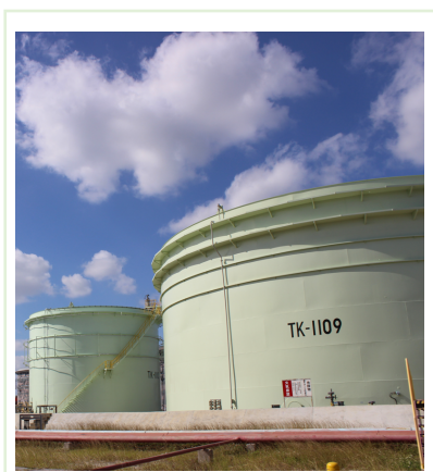
弊社油槽所の製品タンク
