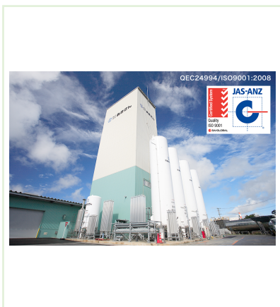
高圧ガス製造プラント
