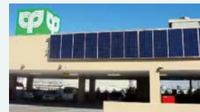
建物壁面に設置したソーラーパネル
