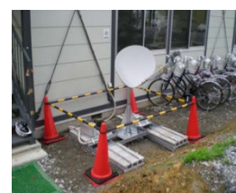
【VSAT設置状況】
