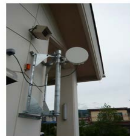
【FWA設置状況】
