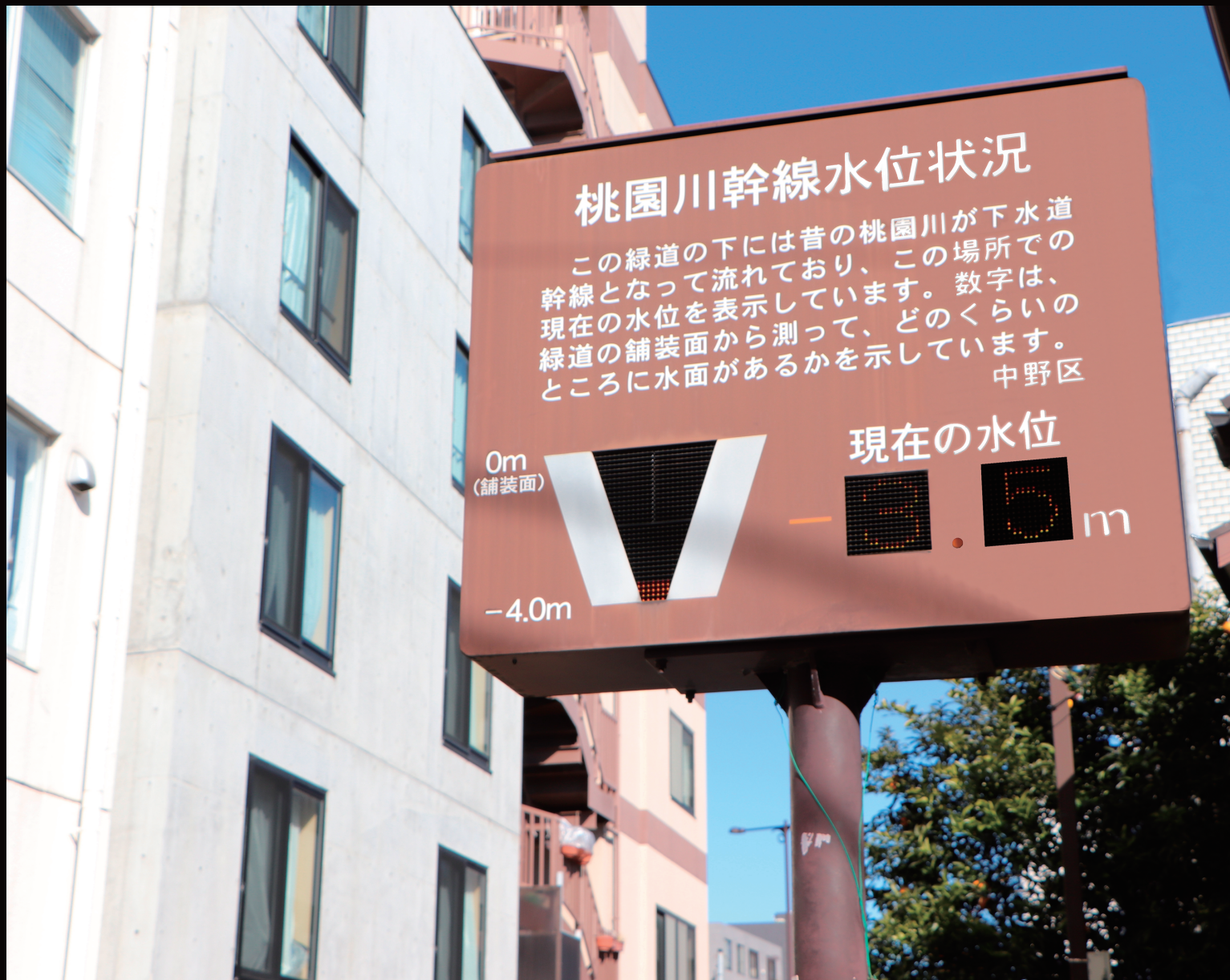
下水道光ファイバーを活用し、幹線の水位情報を電光掲示板にリアルタイムで表示（東京都中野区）
