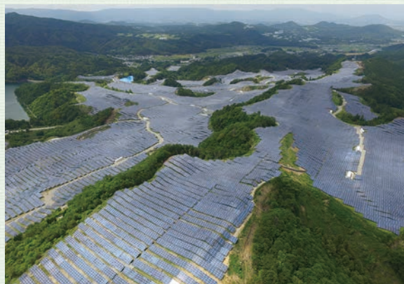
松阪太陽光発電所
