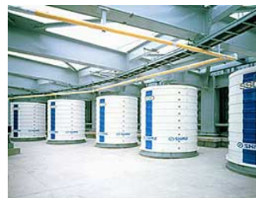
写真-18 スーパースロッシングダンパー
