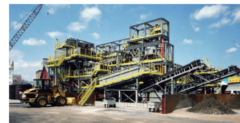
土壌洗浄プラント
