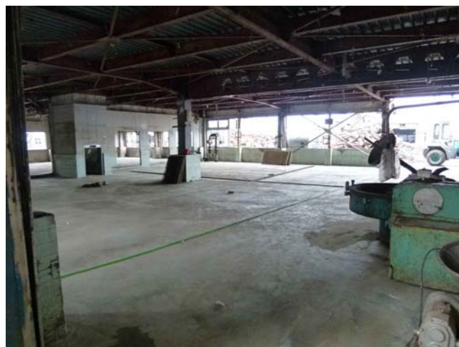
津波被害後清掃された工場内（2011年9月）
