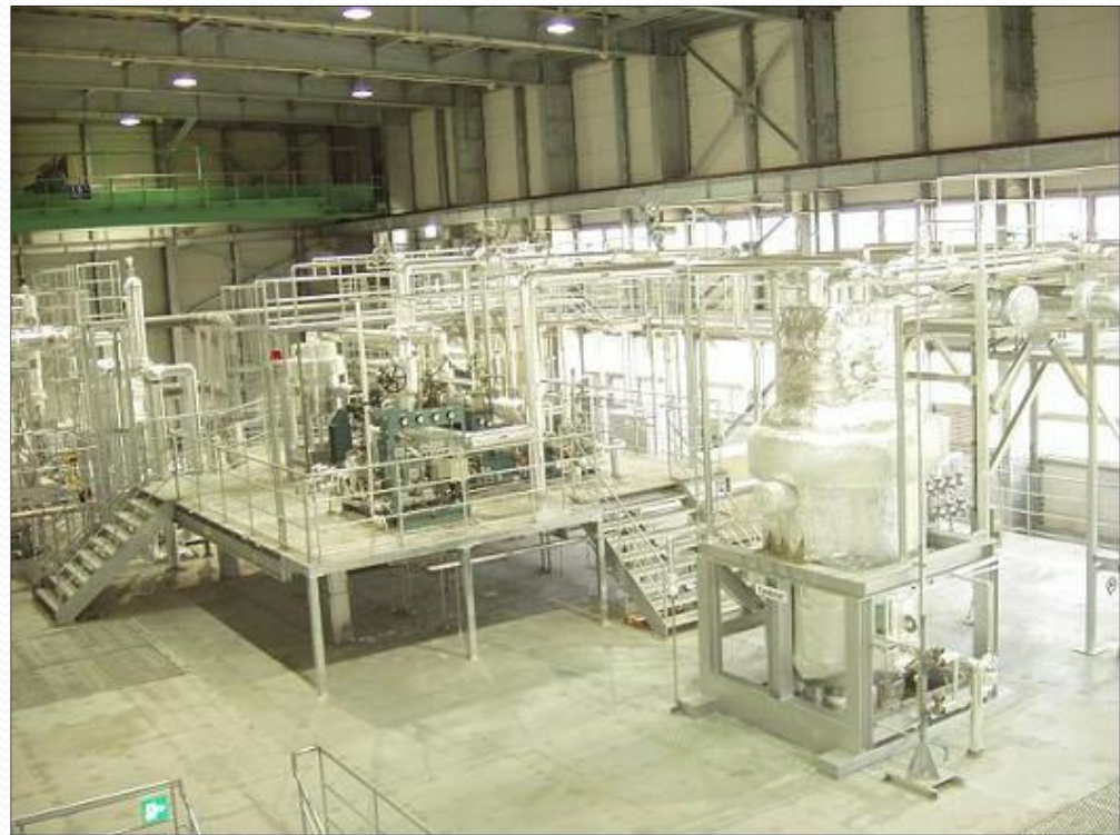
30kW ウエハラサイクル OTECプラント
