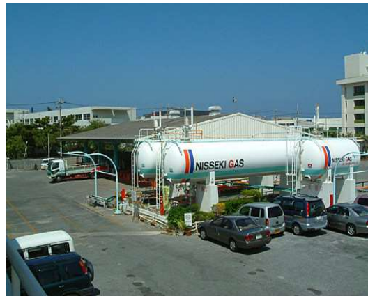
浦添物流センター LPガス充填所
