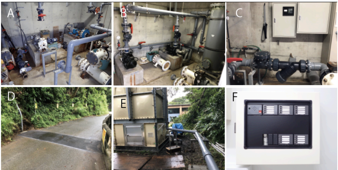
図 7. 取水ポンプ関係. A: 従来のポンプ室. B: 新規導入した自吸式ヒューガルポンプ 2 台. C: 新たな盤とストレーナー. D: 新たに海水配管を埋設した部分 (三浦市道). E: 新たな受水槽に連結した海水配管. F: 教育棟採集職員室に設置された盤.
