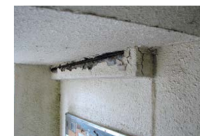
踊り場受ブラケット損傷状況(軽微)
