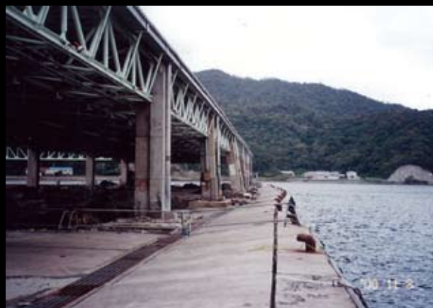
岸壁が破損した境漁港
