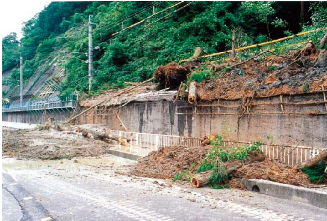
余震で新たに流出した土砂で覆われた国道181号とJR伯備線。線路復旧作業中だった作業員らは、間一髪難を逃れた。（日野町） 鳥取県西部地震（平成12年10月）鉄道復旧記録誌（西日本旅客鉄道株式会社米子支社刊）から転載
