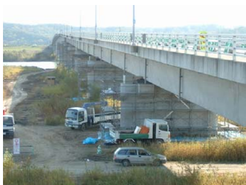
国道 336 号十勝河口橋 (橋脚が 35cm ずれる)
