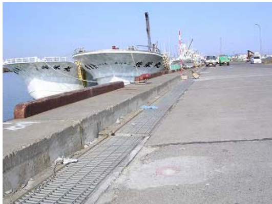
写真—21 大津漁港 エプロン沈下
