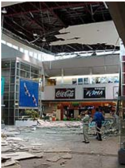
釧路空港出発ロビー 天井パネルの落下
