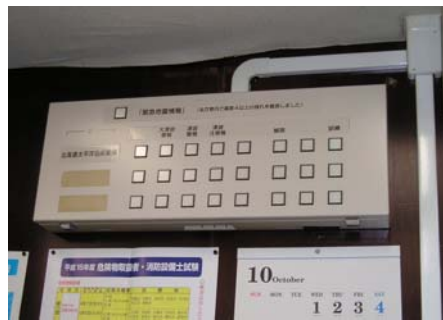
津波警報等緊急伝達システム表示盤
