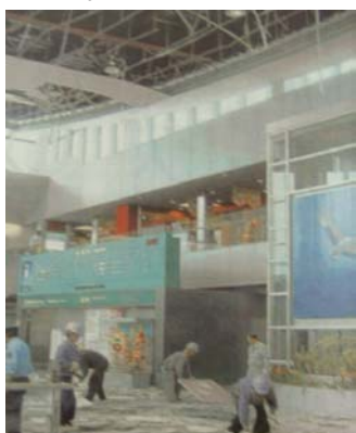
釧路空港出発ロビーの天井パネルの落下(9月26日)
