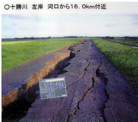
写真-9 十勝川 縦断亀裂
