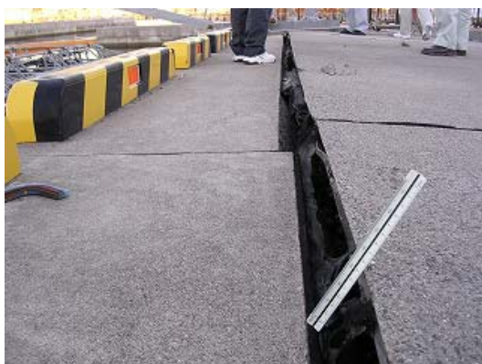
写真-1 浦河港 エプロン段差
