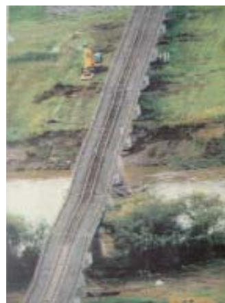
池田町利別川に架かる橋の線路のゆがみ（復旧済）
