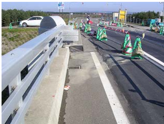
写真-1 3 十勝河口橋 上部工横ずれ
