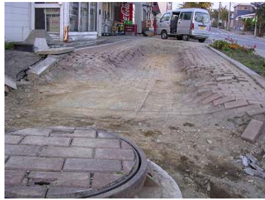
写真-1 2 豊頃町駅前マンホールせり上がり
