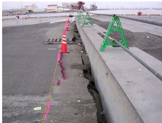
写真一 2 5 釧路港 背後用地沈下
