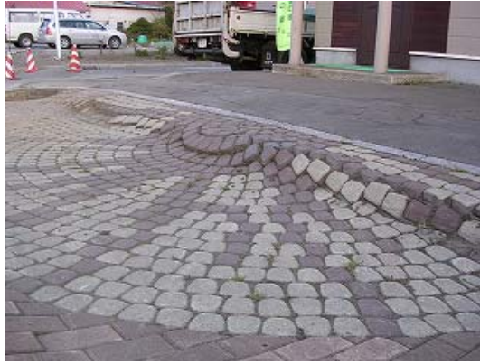
写真-1 1 豊頃町駅前歩道沈下
