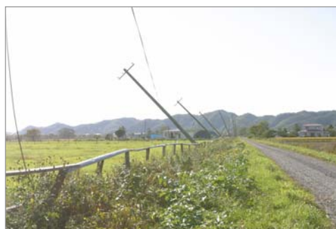
電柱の傾斜（浦河町）
