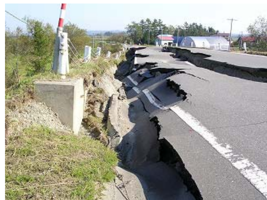
写真一18 下頃辺川 愛牛橋取付け道被害
