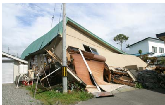
倒壊した倉庫（浦河町） （1階が車庫になっている。）
