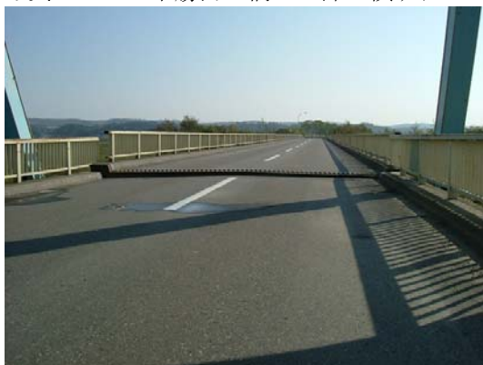
写真-1 5 十勝河口橋 上部工横ずれ
