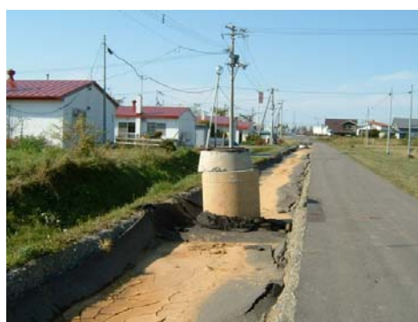
液状化による下水道施設の被害
