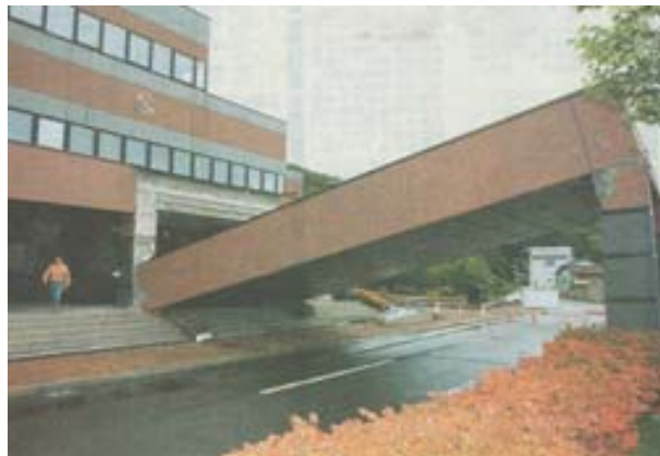
釧路町役場 玄関庇の落下
