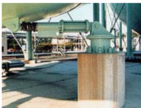
オイルダンパーによりガスホルダーの揺れを吸収（供給設備被害なし）
