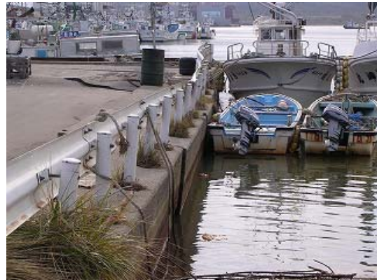
写真—22 大津漁港 船揚場袖護岸上部変位
