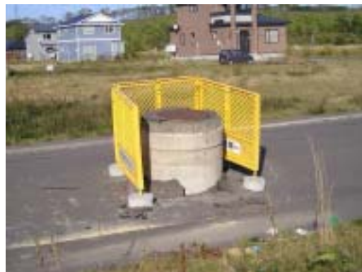
東陽団地における液状化被害
