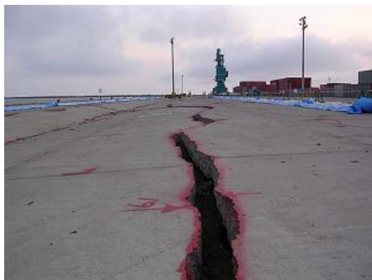
写真一 2 4 釧路港第 4 埠頭コンクリート舗装沈下、クラック
