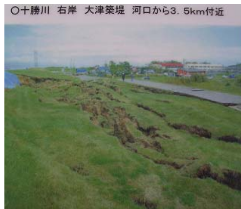
写真-10 十勝川 法すべり
