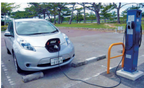
電気自動車の急速充電設備
