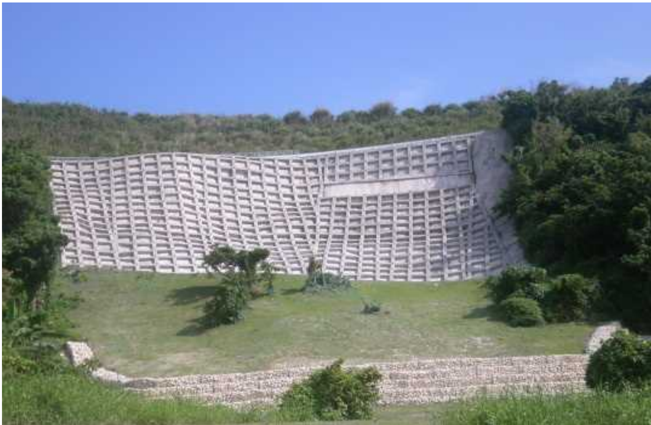
地すべり防止施設
