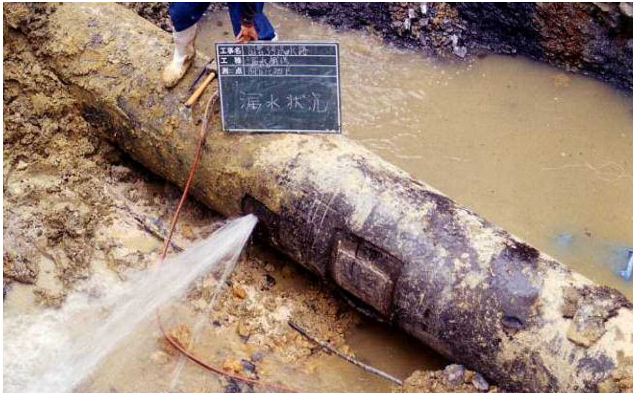
農業水利施設の漏水状況
