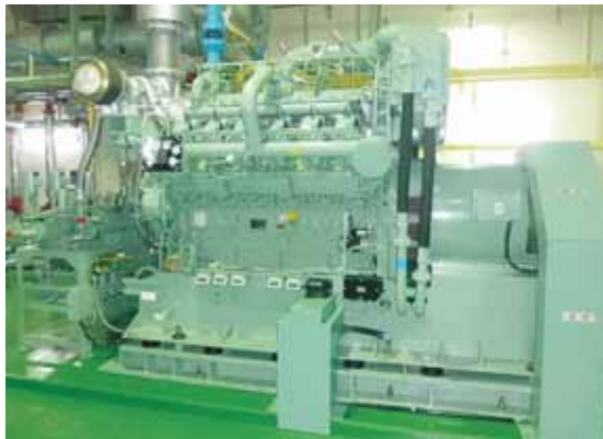
消化ガス発電機
