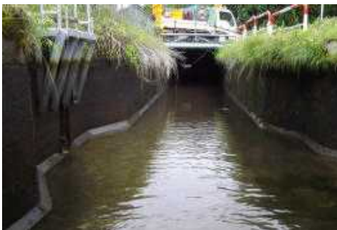
<老朽化した用水路（補修前）>
