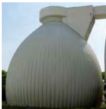
汚泥消化設備 (メタンガスを回収)
