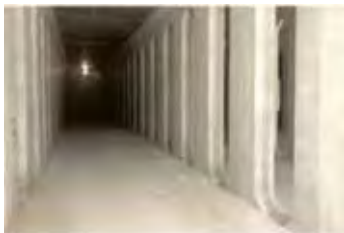
▲【供用中】地下貯留施設(田原本町)
