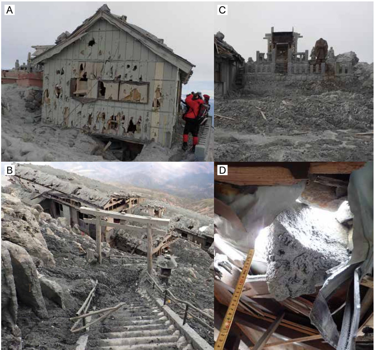
〈図13〉建造物の噴石被害。2014年11月及川輝樹撮影。A：御嶽神社頂上奥社祈禱所の火口側の壁。噴石による損傷が激しい。B：噴石によって穴が開いた御嶽頂上山荘・御嶽剣ヶ峰山荘の屋根。C：御嶽神社奥社。神像の頭が損傷して失われている。D：御嶽剣ヶ峰山荘の屋根に突き刺さった噴石。長径70センチほどの大きさ
