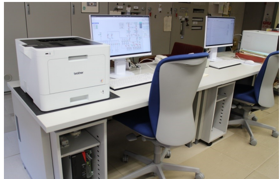
↑ 監視制御装置
