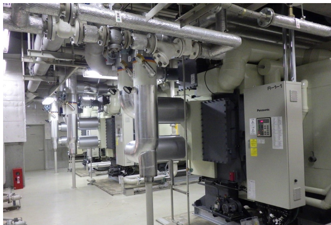
↑ 吸収冷温水機
