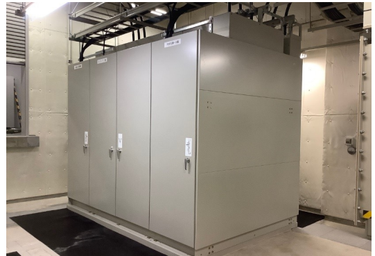
↑ 特高開閉装置
