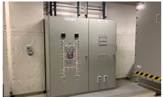
↑ 特高操作盤・特高保護継電器盤
