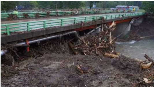
南富良野町 水管橋破損
