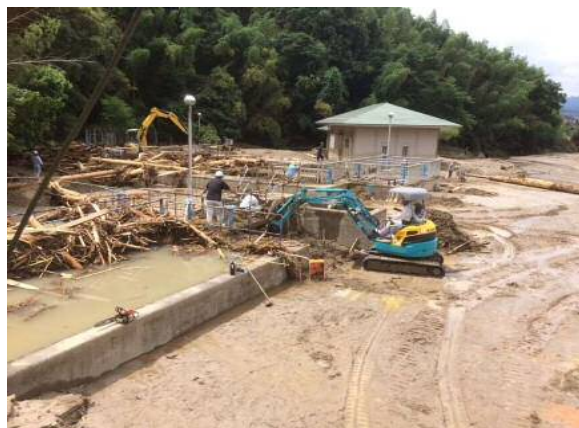
朝倉市 がれき(土砂や流木)が堆積し 浄水機能が停止した杷木浄水場
