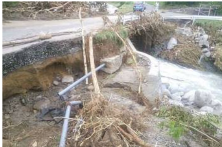
岩泉町 水道管破損
