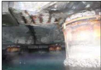
岸壁(上部工)の鉄筋露出
