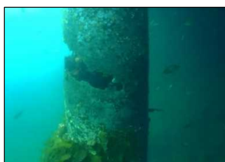
岸壁(鋼管杭)の腐食
