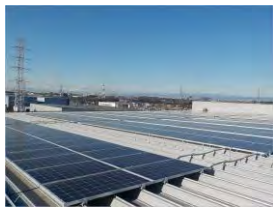
岩槻ロジスティクスセンター (太陽光パネル)
