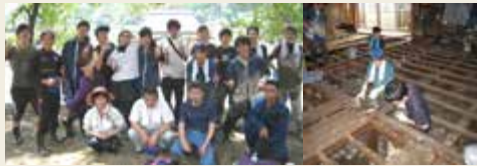
集中豪雨により被害を受けた中津市内の住居の復旧活動の様相
