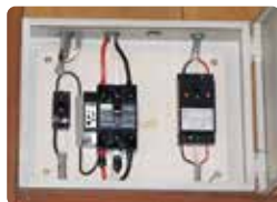
■感震ブレーカー設置状態
