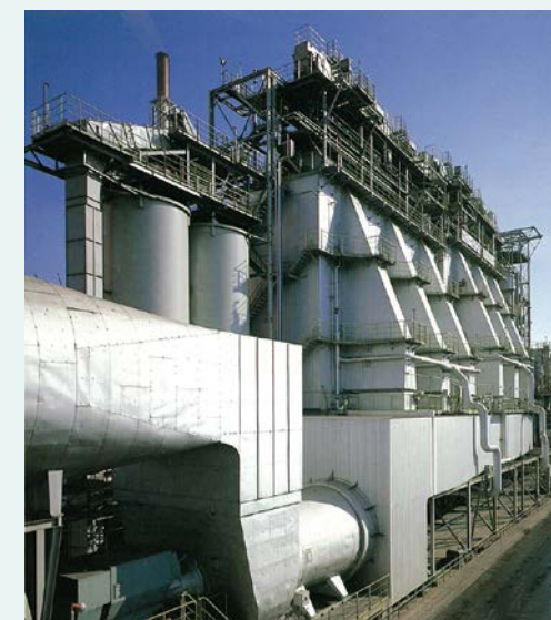
名古屋製鉄所・乾式脱硫脱硝設備
