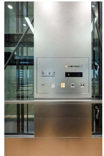
乗用エレベーター 一般用・車いす用兼用操作盤
