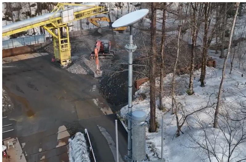
インフラ現場での「Satellite Mobile Link」設置状況
