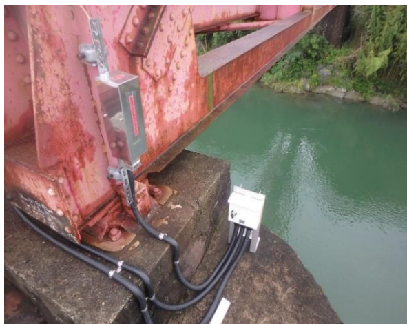
傾斜感知器の実橋梁への設置状況
