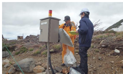
火山ガス濃度の点検
