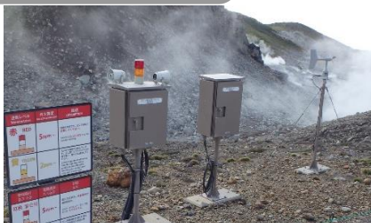
火山ガス濃度観測施設
