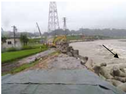
204.8km の堤防決壊状況
