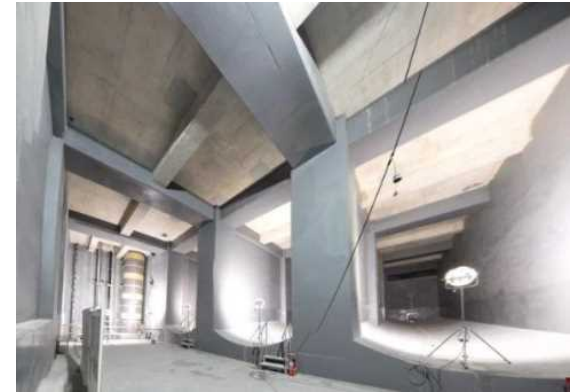
地下貯留ケース
